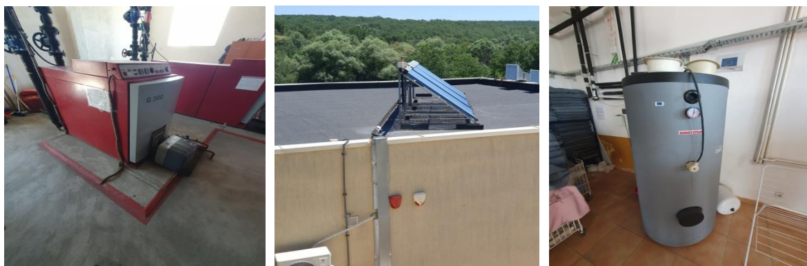
Котел на нафта и соларна система за топла вода и битови нужди
